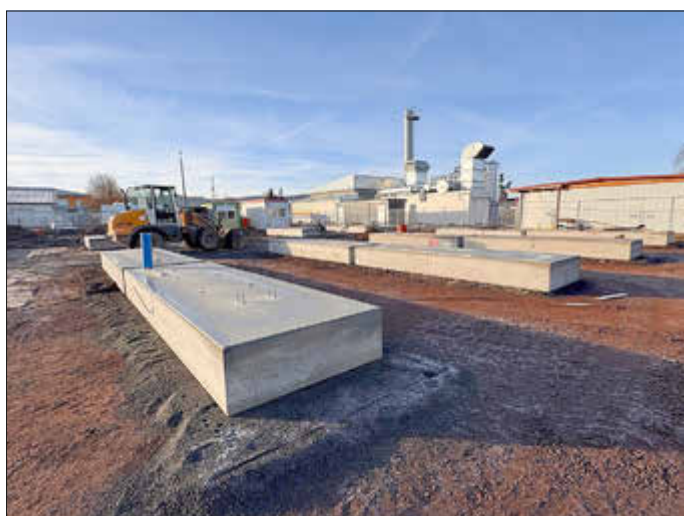
Solarcarport-Fundamente im Vordergrund und das rundum sanierte Heizhaus im Hintergrund.
