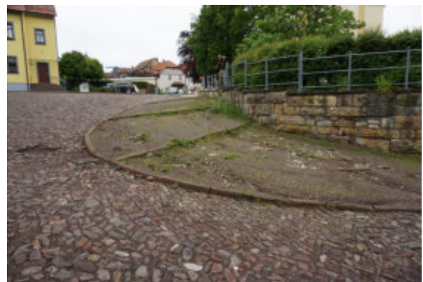
Abb. 31: Bauliche Missstände unterhalb der Kirche in der Kernstadt Ohrdruf Quelle: DSK 2019
