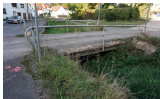
Sanierungsbedürftige Abschnitte entlang des Uferbereichs Quelle: DSK 2019
