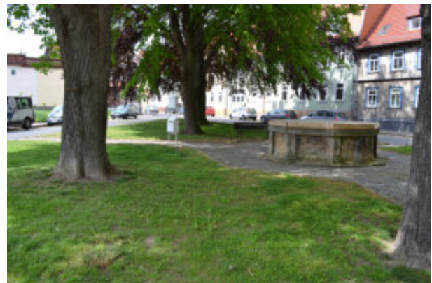
Abb. 32: Sanierungsbedürftiges Brunnenbecken am Michaelisplatz in der Kernstadt Ohrdruf Quelle: DSK 2019
