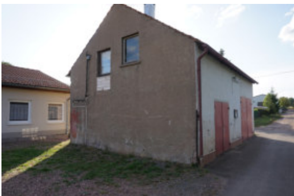
Abb. 57: Sanierungsbedürftiges Feuerwehrgerätehaus Quelle: DSK 2019
