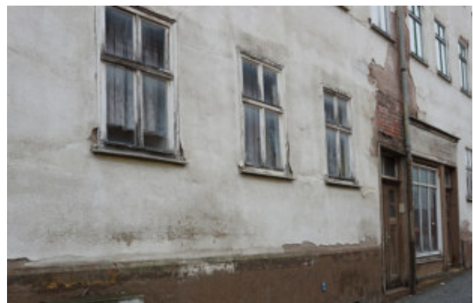
Abb. 29: Hoher energetischer Sanierungsrückstau eines Gebäudes in der Kernstadt Quelle: DSK 2020
