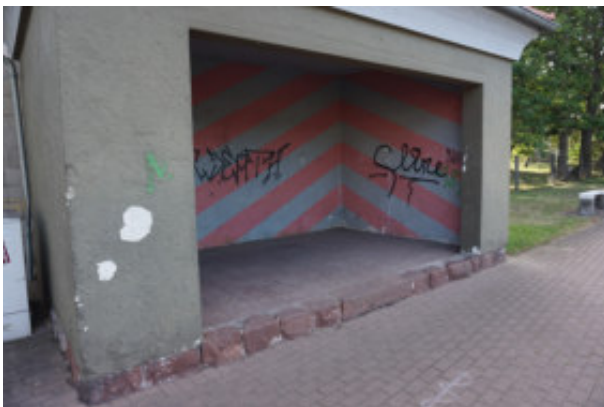
Abb. 56: Bushaltstelle ohne überdachte Sitzgelegenheit und Beleuchtung Quelle: DSK 2019
