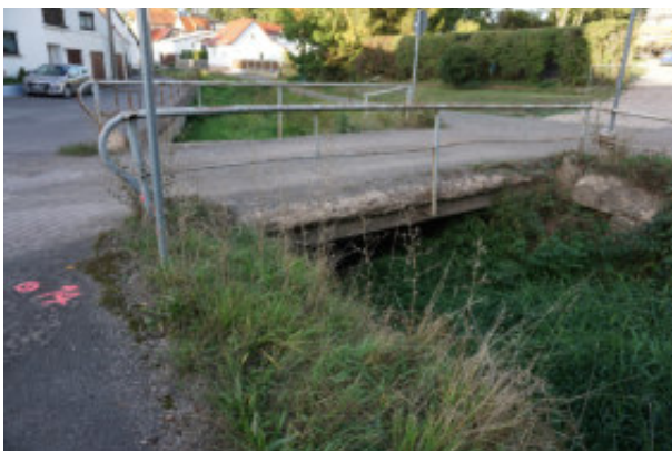
Abb. 69: Baufälliges Brückenbauwerk Steingasse/Langgasse Quelle: DSK 2019
