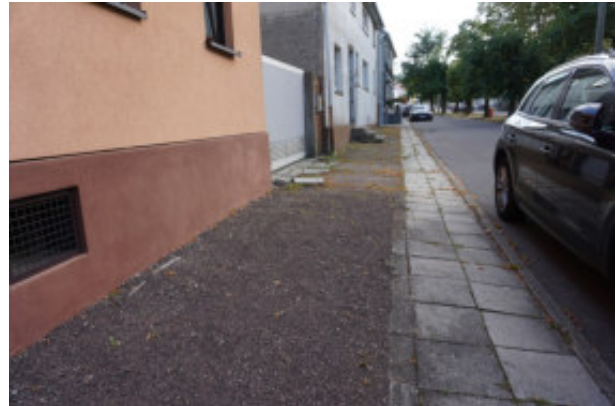
Abb. 58: Mangelhafter Fußweg im Bereich Friedensstraße Quelle: DSK 2019
