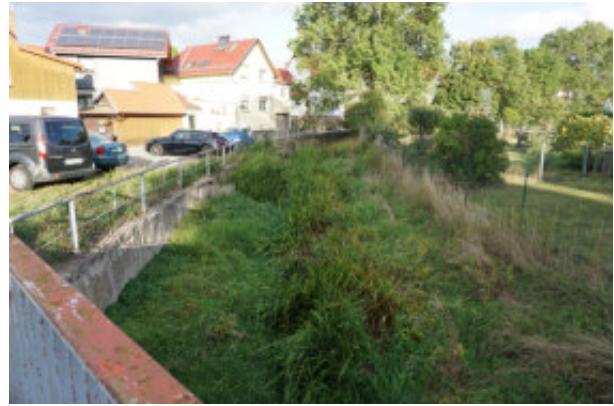
Abb. 70: Sanierungsbedürftiger Bachlauf Stirnstraße Quelle: DSK 2019
