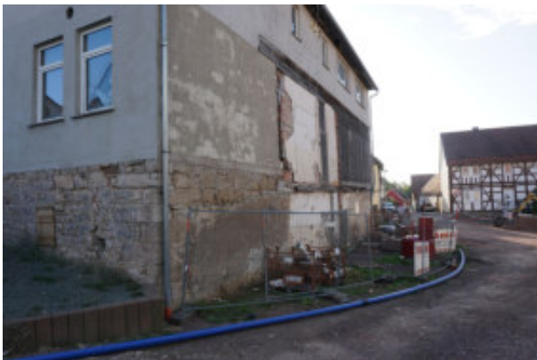
Abb. 68: Laufende Sanierung Käfergasse mit sanierungsbedürftiger Gemein- deschenke. Quelle: DSK 2019
