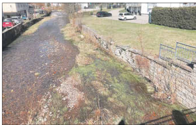
Sanierungsbedürftiges Ohra-Ufer soll in die Kur kommen
